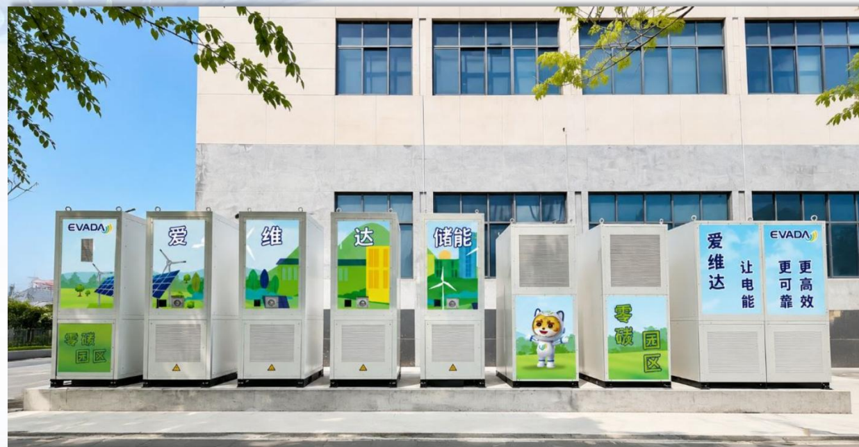
1MW/2MWh储能平台
